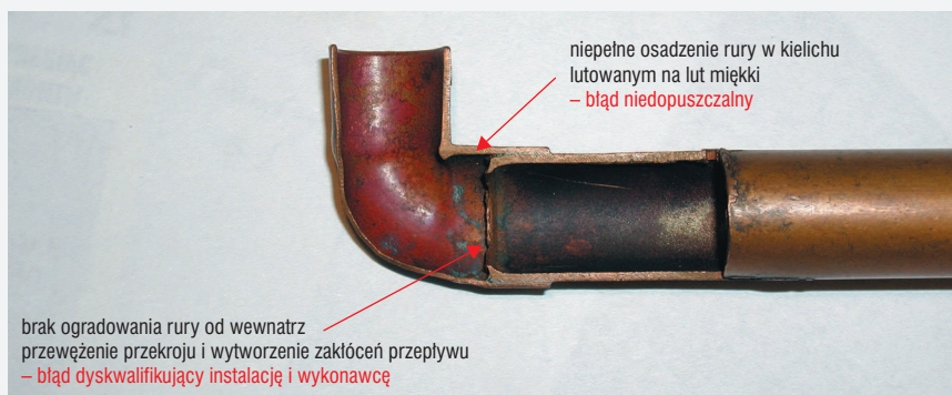
Fot. 1. Błędnie wykonane połączenie lutowane kapilarnie
