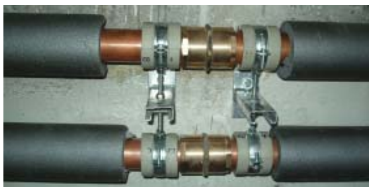
Rys. 3.15.1. Kompensator typu O-yster z widocznymi punktami przesuwymi
